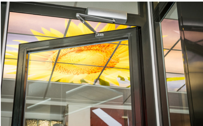
Oviaukkojen suojaukseen liittyvissä palo-ovissa voi olla myös palonkestäviä ikkunoita. Sivut 34–35
